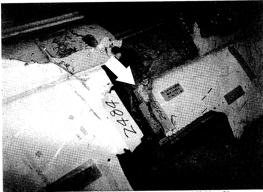
アフト・トルクボックス付根右外板部隅に断熱材が認められる。
